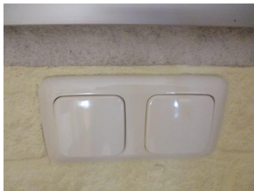
Figuur 7 De verlichting wordt geregeld via een vertrekschakeling. Wanneer de verlichting wordt vervangen kan er voor aanwezigheidsdetectie met daglichtregeling worden gekozen om energie te besparen.
