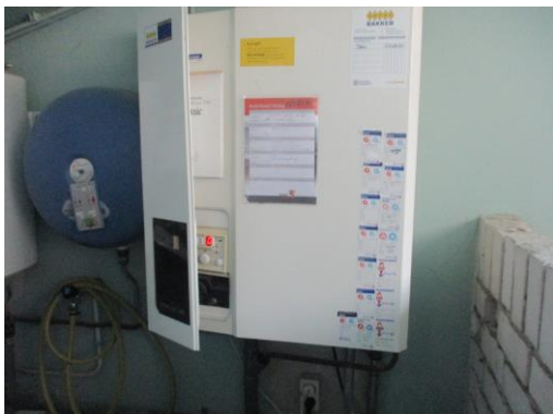
Figuur 4 Het gebouw wordt verwarmd middels een HR107 ketel.
