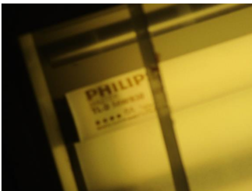
Figuur 6 Overal is nog conventionele tl-verlichting aanwezig, deze kan goed worden vervangen door ledverlichting.
