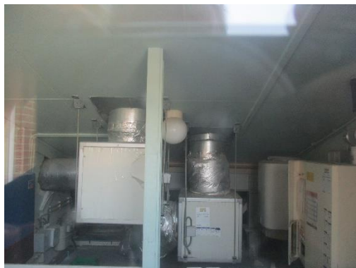
Figuur 5 Er is mechanische afvoerventilatie aanwezig.
