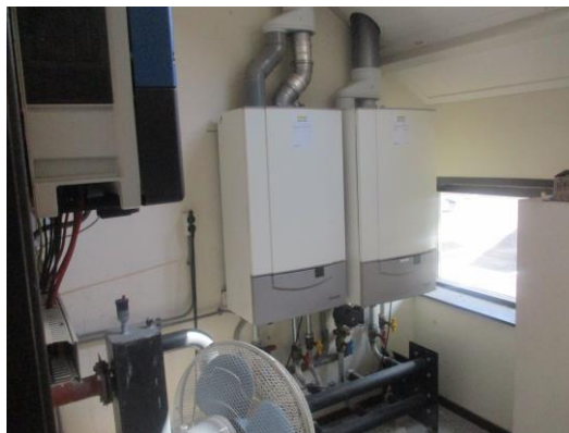
Figuur 5 Het object wordt verwarmd door twee in cascade opgestelde HR107% verwarmingsketels.
