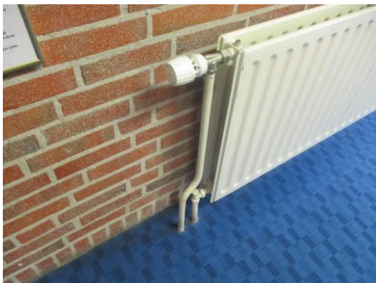
Figuur 4 De warmte wordt afgegeven door plaatradiatoren.
